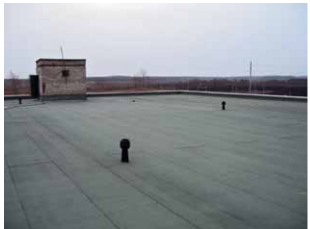
Фото 14 Расположение кровельных аэраторов на крыше
