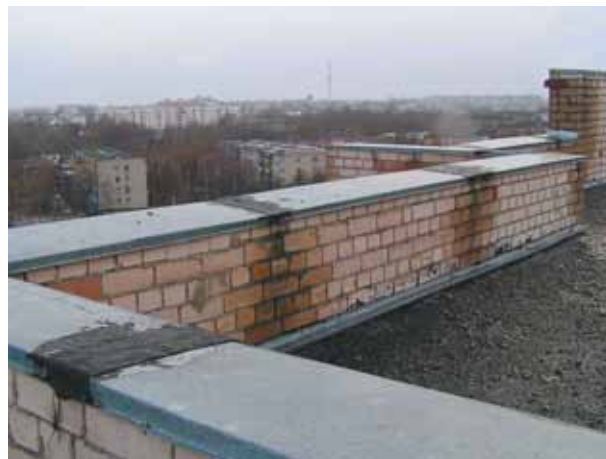
Фото 45 Протечки по швам парапетного покрытия, установленного внахлест
