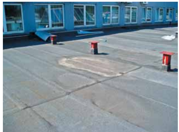
Фото 24 Отсутствие разбежки торцевых швов
