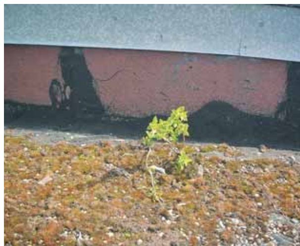
Фото 6 Биологическое разрушение кровельного ковра
