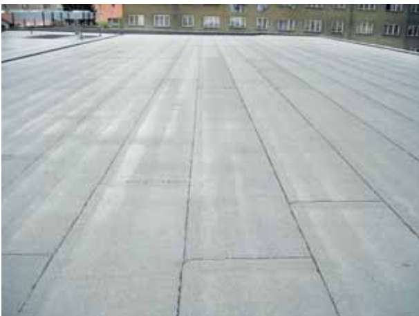
Фото 11 Вытек вяжущего из-под боковой кромки материала
