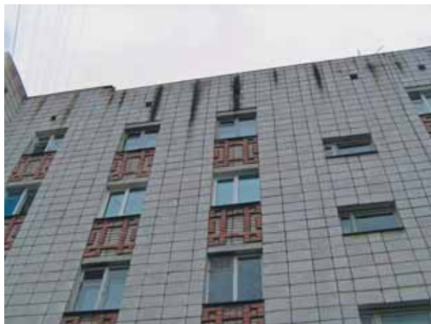
Фото 44 Следы протечек на фасаде по парапетному покрытию
