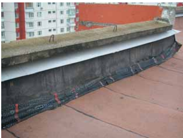
Фото 36 Отслоение материала от вертикальной поверхности
