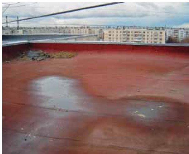
Фото 2 Зона застоя воды на кровле
