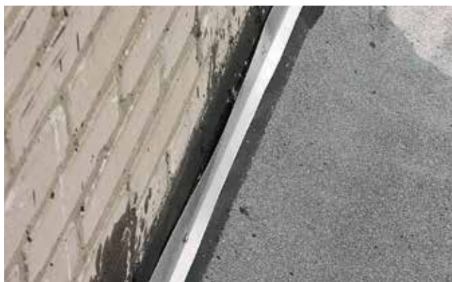
Рис. 4.14. Отсутствие герметика на верхнем отгибе защитного фартука
