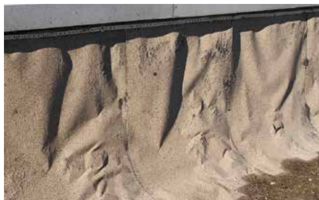
Рис. 4.12. Отслоение верхней кромки кровельного материала
