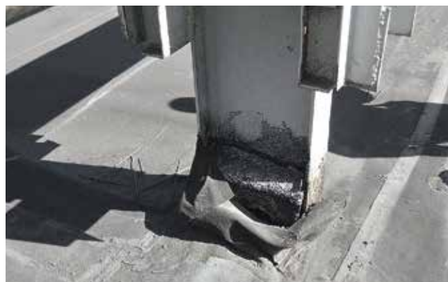
Рис. 4.22. Неправильное выполнение примыкания
