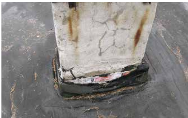
Рис. 4.10. Сползание кровельного материала с вертикальной поверхности
