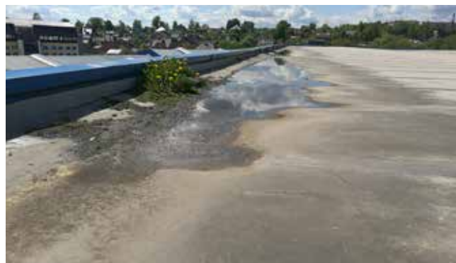
Рис. 4.6. Биологическое разрушение кровли
