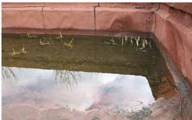
4.16. Засорение водоприемных воронок
