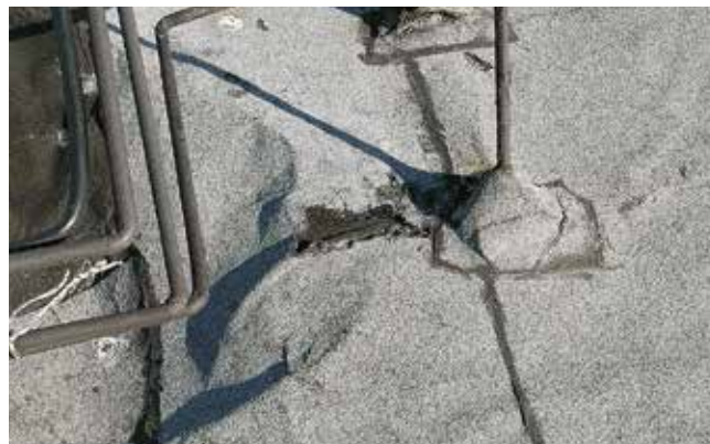
Рис. 4.19. Ошибки в устройствах примыкания к элементам крыши
