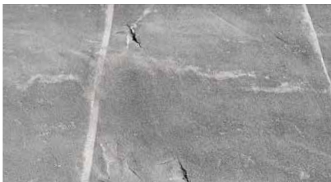
Рис. 4.3. Механическое повреждение кровли
