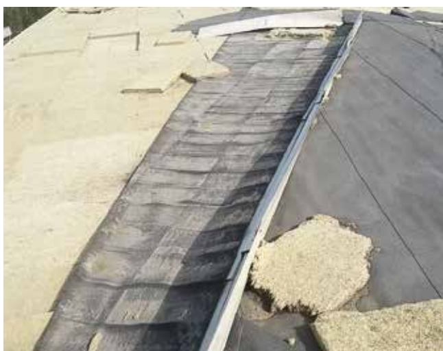
Рис. 4.1. Отрыв кровельного ковра от основания
