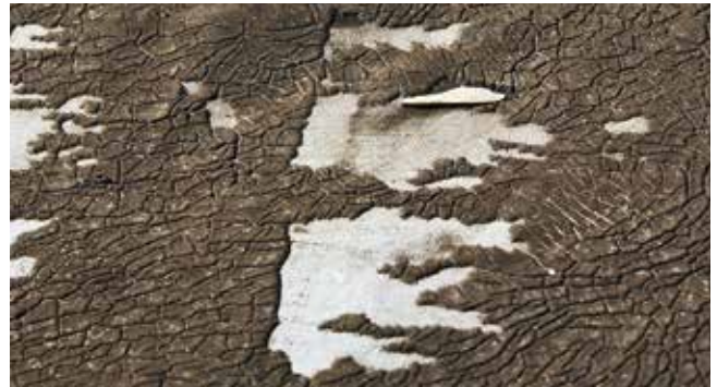
Рис. 4.9. Разрушение верхнего покровного слоя материала до основы
