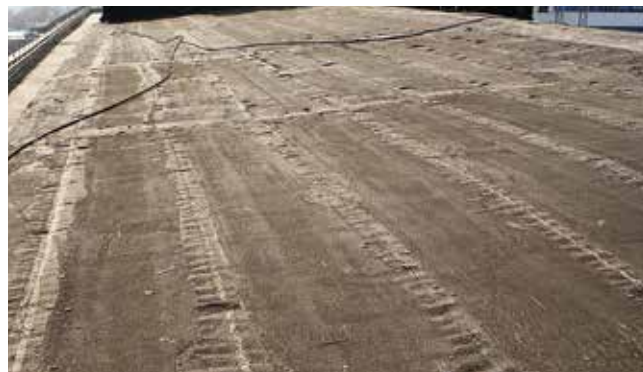
Рис. 4.2. Отсутствие защитной крупнозернистой посыпки
