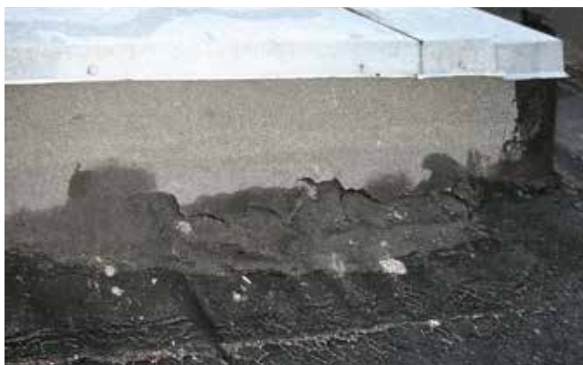
Рис. 4.11. Механическое повреждение кровли
