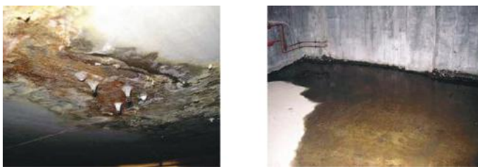
Рис. 5.2. Последствия неудовлетворительной системы гидроизоляционной защиты
