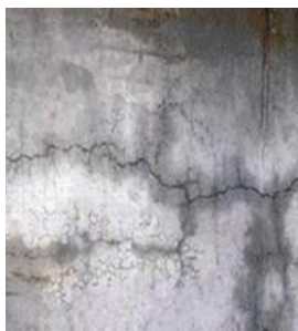
Рис. 5.6. Усадочные трещины в бетоне
